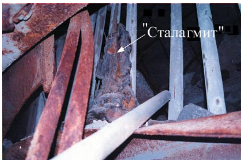
Рис. 6.13. Скопление лавы «сталагмит», являющийся продолжением «сосульки» ЛТСМ, свисающей с бетонной плиты
