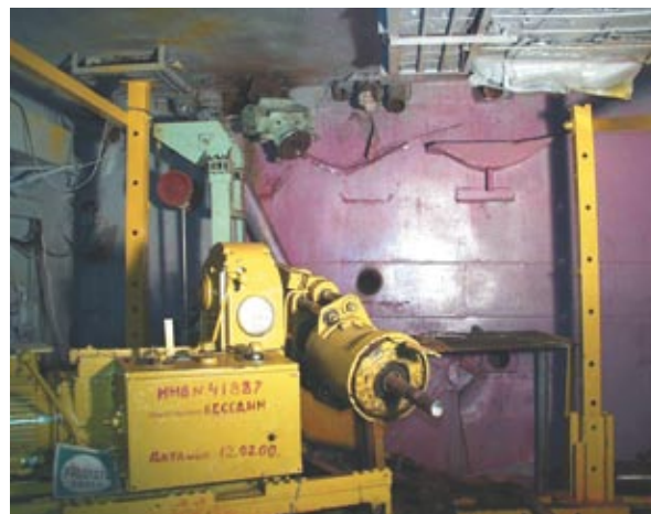
Рис. 3.5. Превентор (вход) скважины в пом. 515/3. Скважина пробурена в шахту реактора
