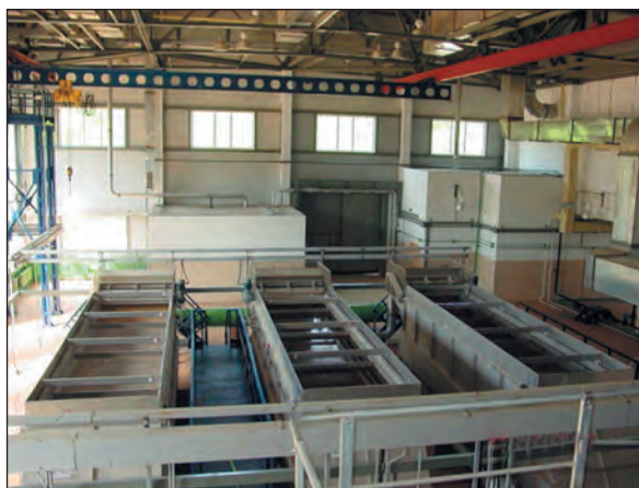
Рис. 4.1.16. Внутренний вид комплекса коагуляции, флотации и обеззараживания
