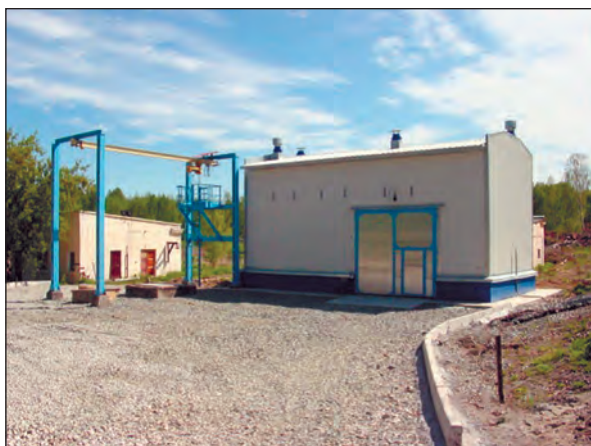
Рис. 4.1.15. Одна из пяти насосных станций системы общесплавной канализации
