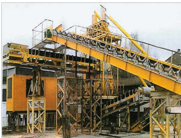
Рис. 3. Установка для 100-процентного измерения измельченного кирпича и кладки производительностью 50 т/час
