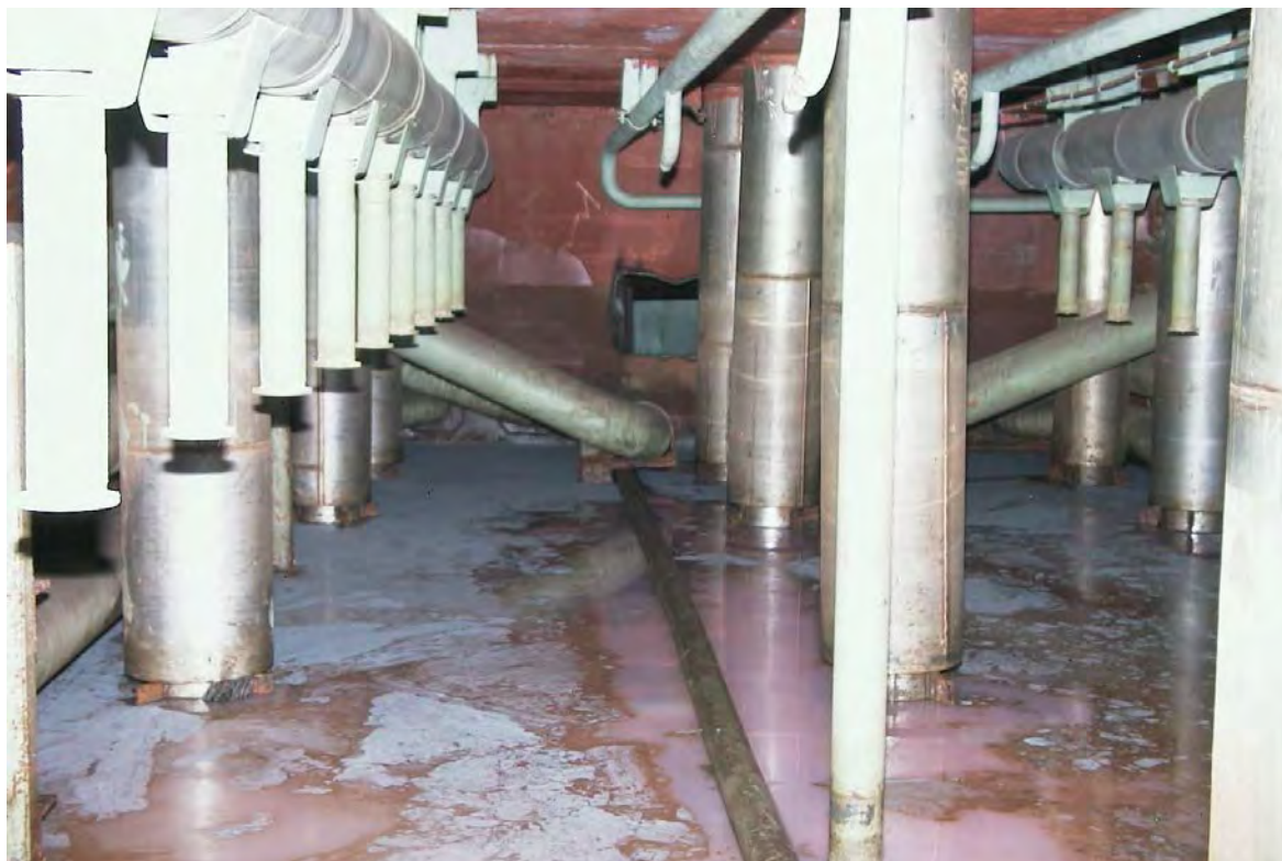
Рис. 24. Скопление воды на 2-ом этаже бассейна-барботера.
