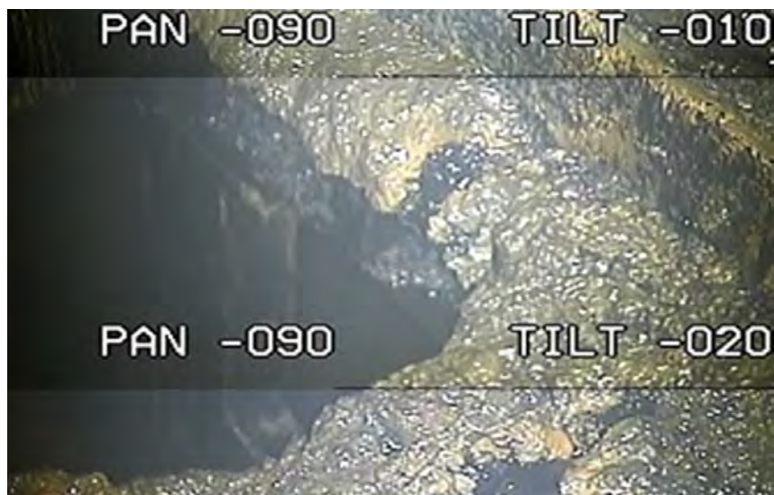
Рис. 137. Провал от упавшей части опорной решетке обнаруженный 30.01.17.
