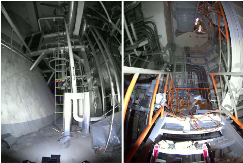
Рис. 119. Фото, сделанные Quince 1 во время 3-го сеанса. Слева – снимок трубопровода системы охлаждения. Справа – куча обломков, блокирующая лестницу на 3-ий этаж.
