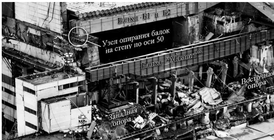
Трубный накат, балки, на которые опирается верхняя часть «Укрытия» и их опоры
