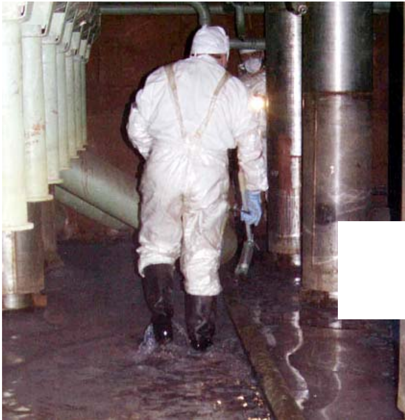
Рис. 32. Вода, проникающая на нижние отметки объекта «Укрытие».
